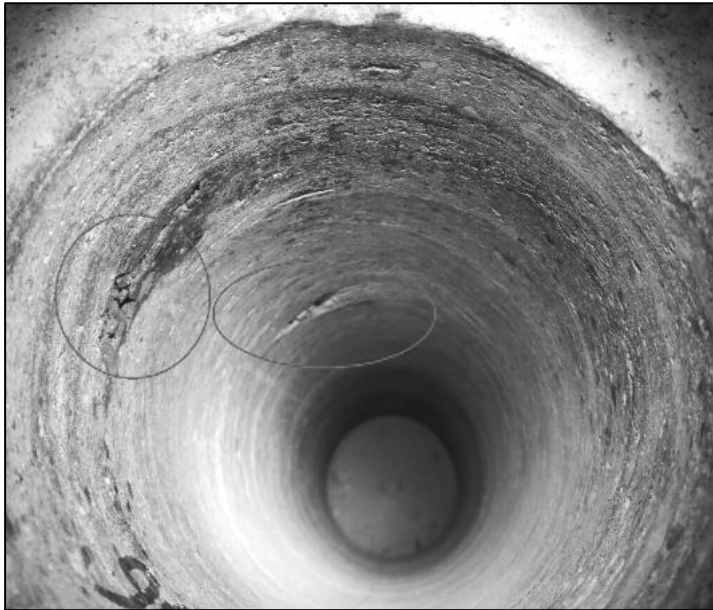
Abbildung 106: Bereiche mit Rissen, Fehlstellen und erhöhter Porosität in den Bohrungen am GSBV2
