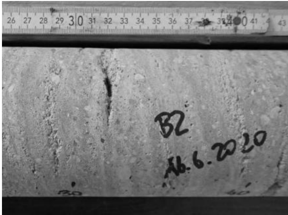
Abbildung 88: Riss am Kern der B2
