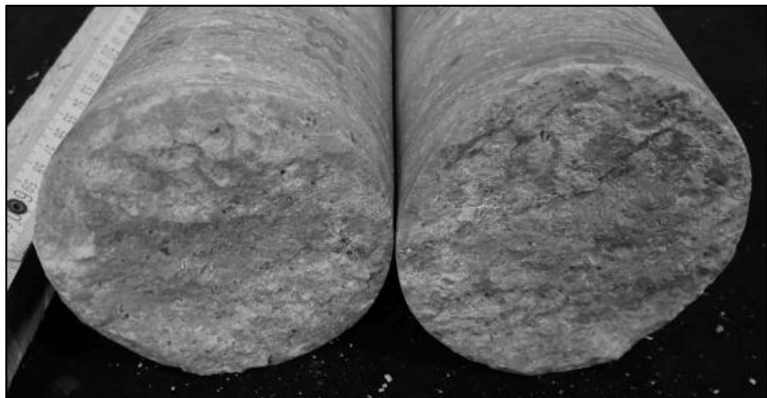
Abbildung 232: Bohrung B33 im GSBV4, Fläche im Bereich der Inhomogenität bei 63...64 cm, ohne Verbund bei der Bohrkernentnahme
