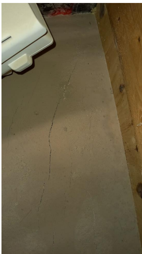
Abbildung 76: Oberflächenrisse an der Schalung
