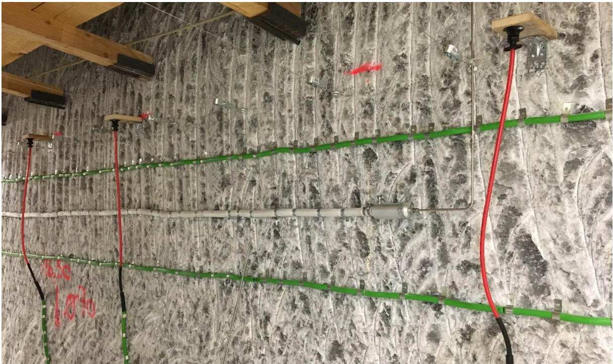
Abbildung 42: Horizontale Ringkammer HK01 zwischen den horizontalen Injektionsleitungen
